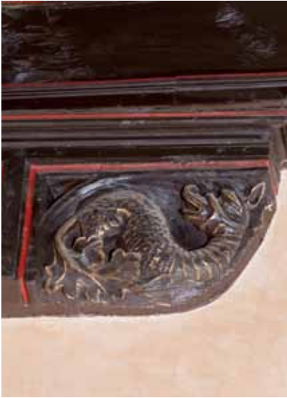
Ménsula de la jácena 1 (muro norte). Dragón.
